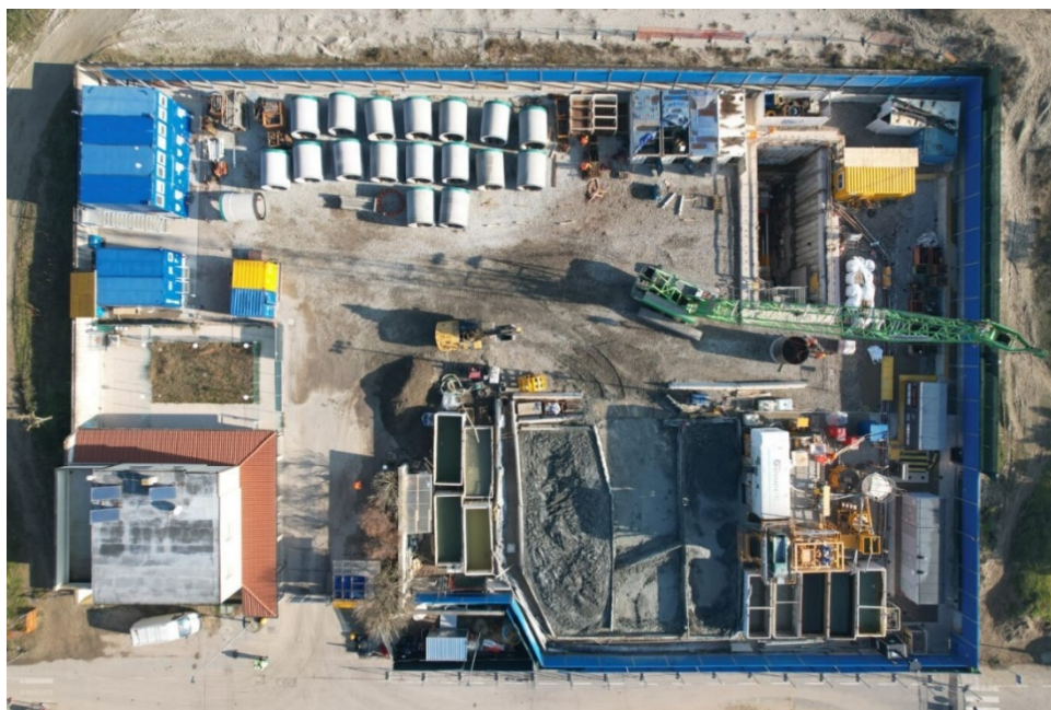
Figura -9 Barriere fonoassorbenti perimetrali
