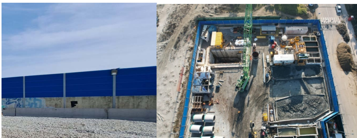
Figura -8 Barriere fonoassorbenti installate
