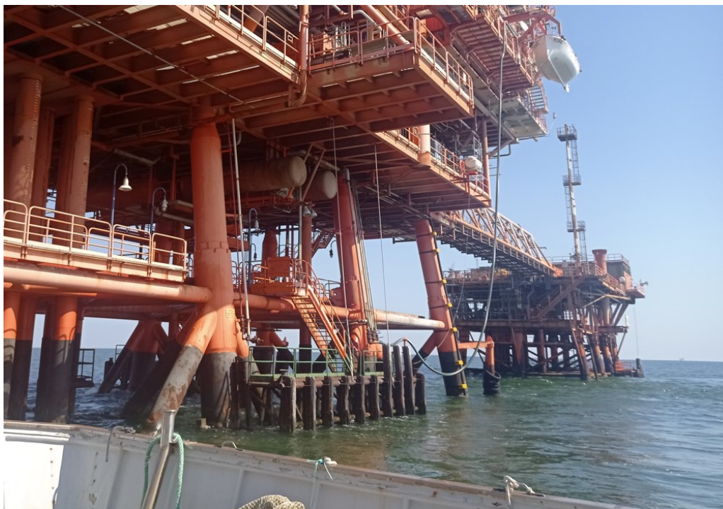
Figura 2.6 Piattaforma Porto Corsini WB
