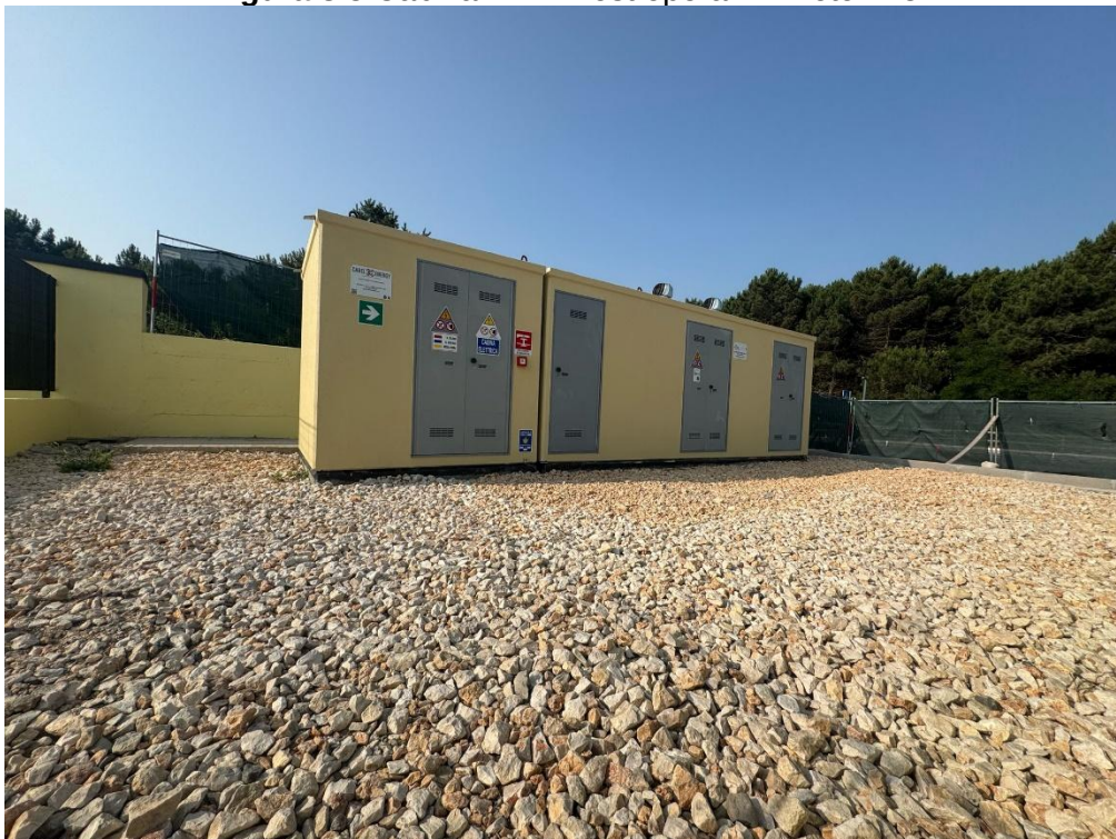
Figura 3.5 Cabina MT – Post operam – Foto n. 5
