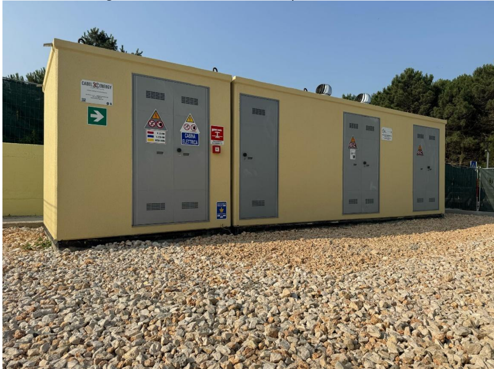
Figura 3.4 Cabina MT – Post operam – Foto n. 4
