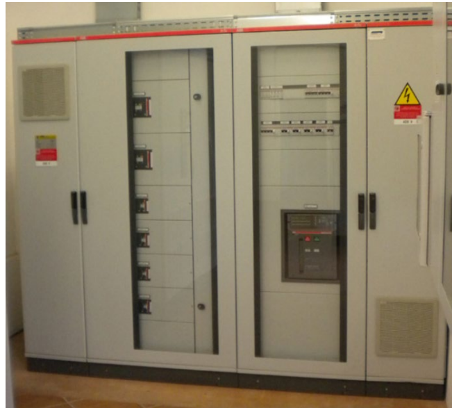
Figura 26: Quadro di parallelo inverter installato nella sezione BT delle power station
