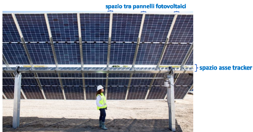
Foto n°1: Esempio costruttivo di impianto fotovoltaico doppio-pannello monoassiale con rotazione su asse orizzontale
