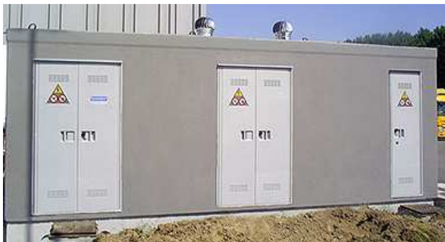
Foto n°3: Prospetto frontale cabina di consegna
