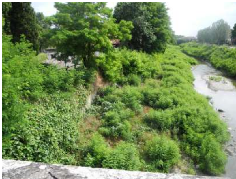
Figura 4 - Vista sponda sinistra a valle del ponte Salvaterra (accumulo materiale al piede del muro)
