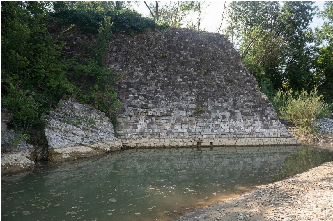
Figura 36: Opera di presa esistente Canale del Mulino. Fianco ovest lato Trebbia.
