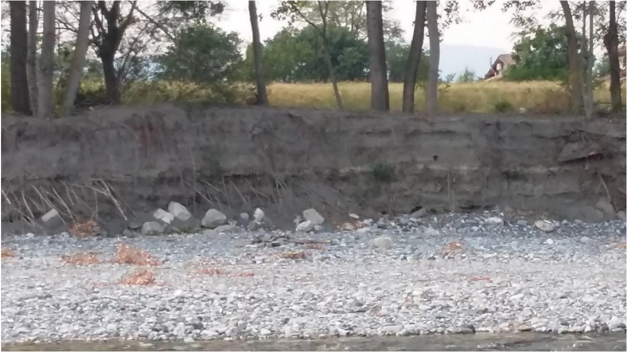
Figura 14: Scarpa di terrazzo alluvionale in sinistra idrografica con presenza di erosione spondale.
