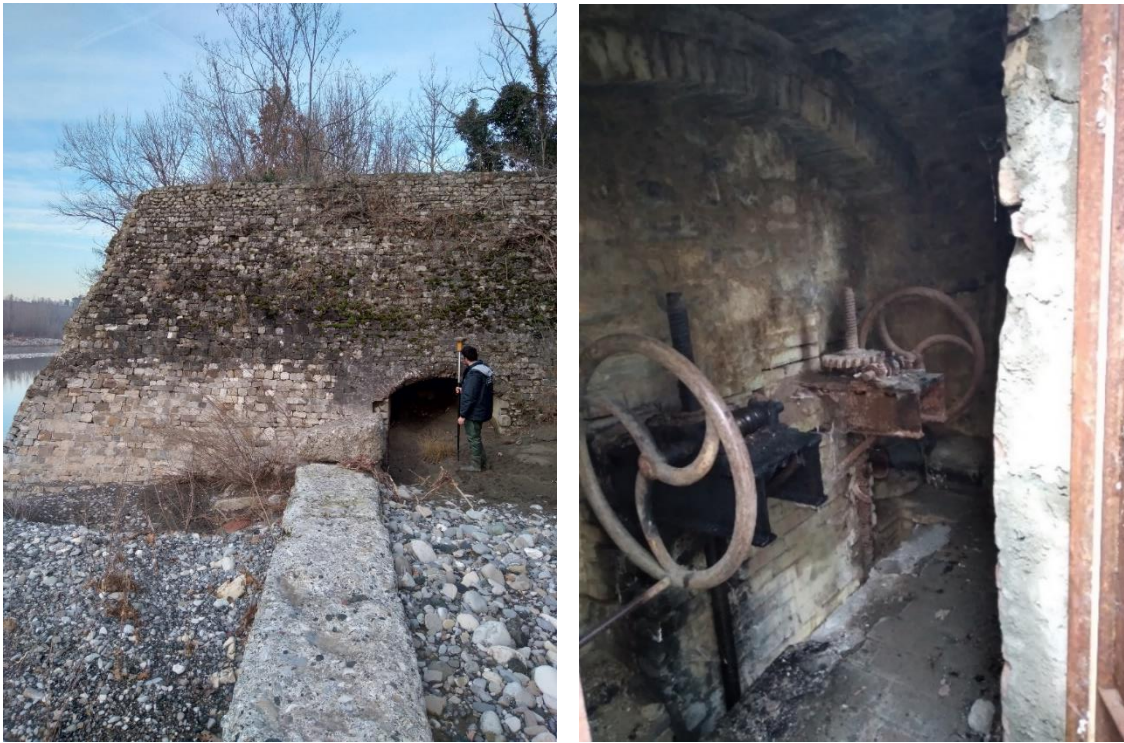
Figura 18: Opera di presa esistente, Canale del Mulino e attrezzature interne di regolazione.
