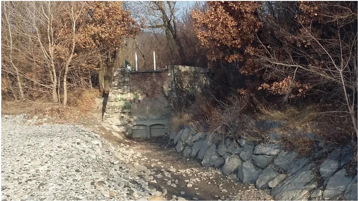
Figura 6: opera di presa esistente del Rivo Villano durante il periodo non irriguo.
