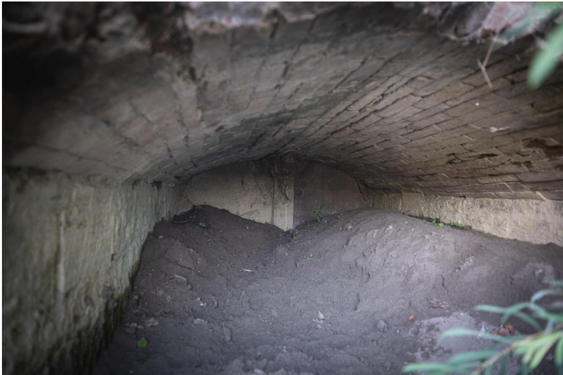
Figura 35: Opera di presa esistente, ostruzione.
