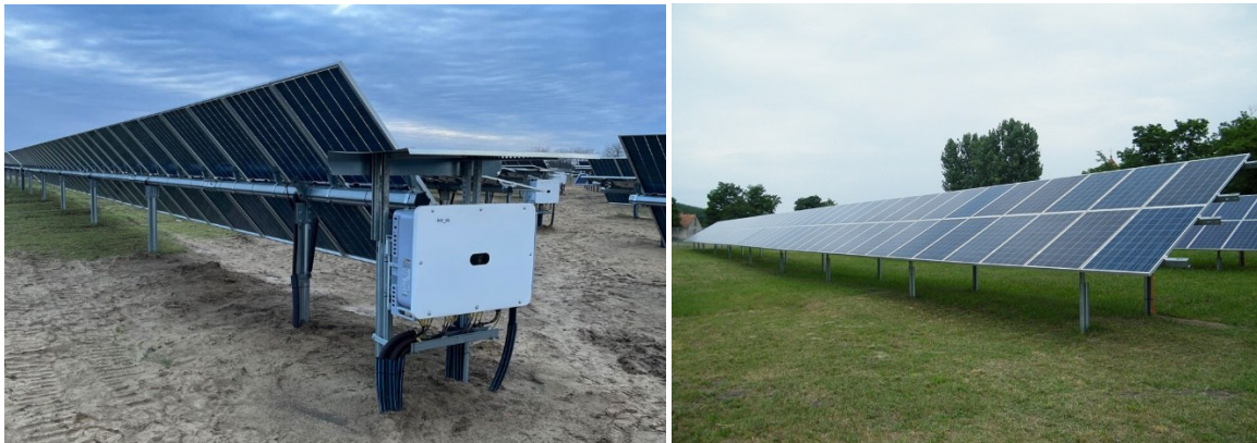
Figura 12 – Esempi di strutture a terra per impianti fotovoltaici
