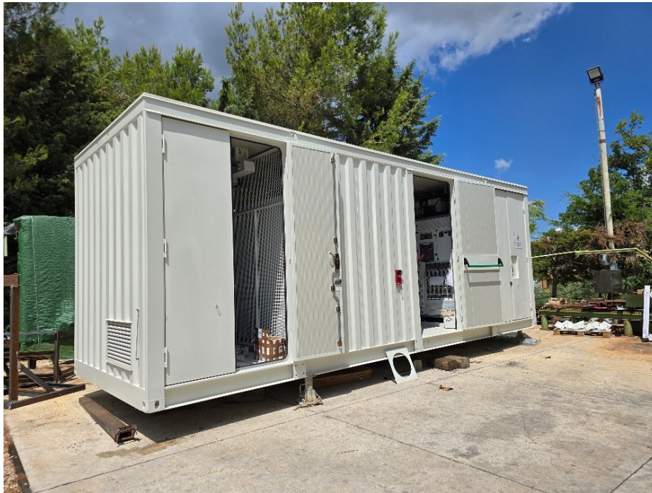
Figura 24: Cabine previste adibite all'elevazione di tensione.
