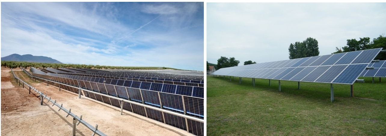
Figura 20: Esempi di strutture con sistemi tracker (destra) e sistemi fissi (sinistra).
