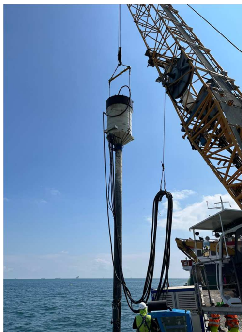
Figura 1-7: Fase esecutiva della colonna in ghiaia. In primo piano il braccio della gru a traliccio posta sul moto pontone che sorregge “l’ago” nel procinto di penetrare nel fondale marino. L’ago è sormontato da una tramoggia che contiene la ghiaia che verrà iniettata nel terreno per la formazione della colonna. Ogni colonna, in condizioni ideali, richiede circa 20-25 minuti per essere realizzata.
