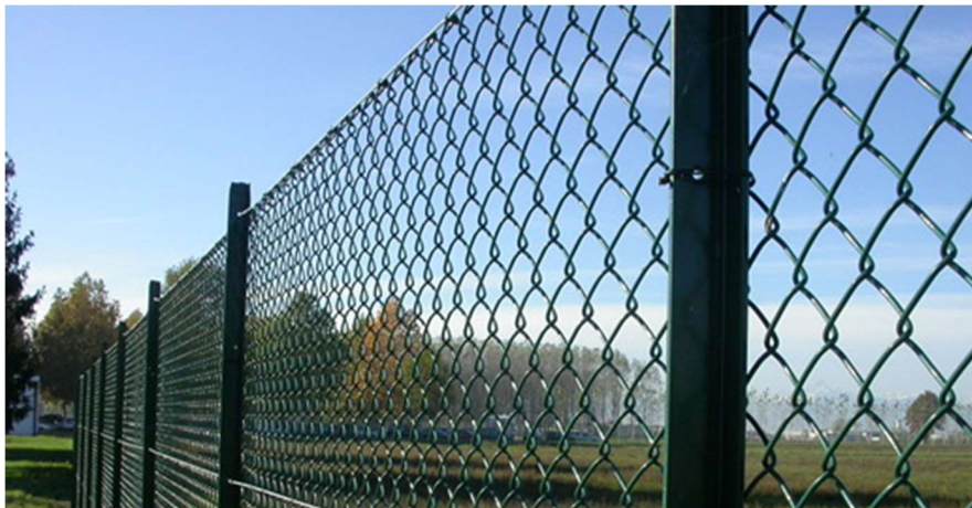
Figura 5-3 Esempio di recinzione perimetrale con pali ad infissione nel terreno senza utilizzo di plinti in cemento
