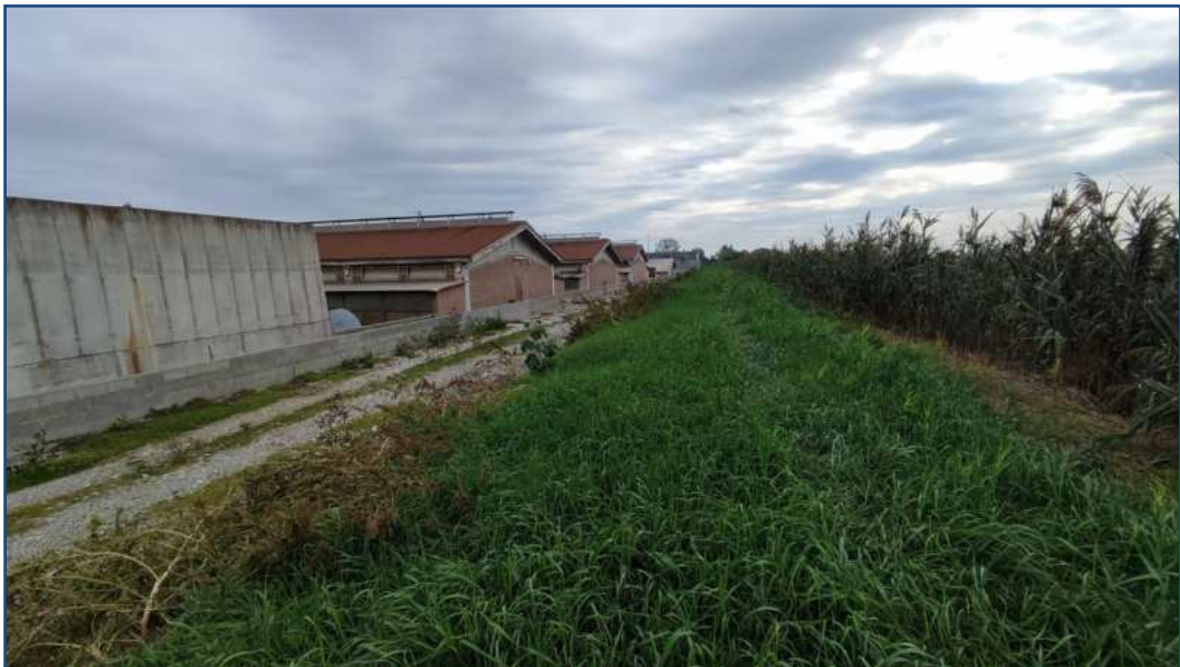
Foto 8 – Argine perimetrale esterno sul lato nord ripreso da ovest verso est. A destra è presente la recinzione di sicurezza coperta da vegetazione e a sinistra è presente il fosso di guardia al piede dell'argine. A sinistra sono visibili alcuni fabbricati dell'allevamento suinicolo e altre strutture aziendali.
