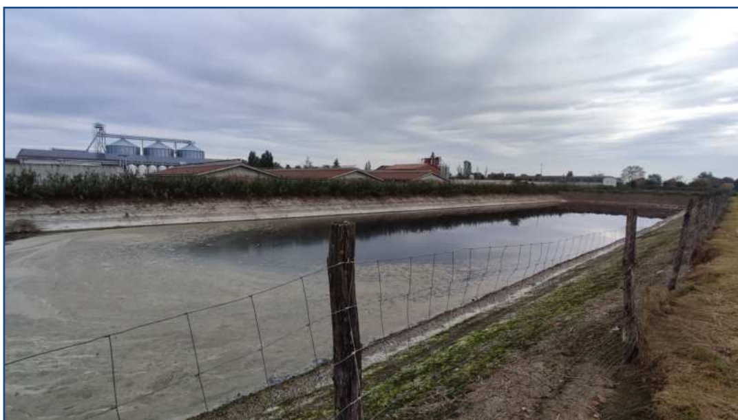
Foto 5 – Veduta interna della vasca ovest ripresa dall'angolo sud-ovest. Sulla sommità dell'argine perimetrale esterno è presente la recinzione di sicurezza.
