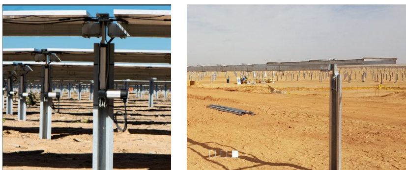
Figura 6 - Particolare strutture ad inseguimento ed attuttore
