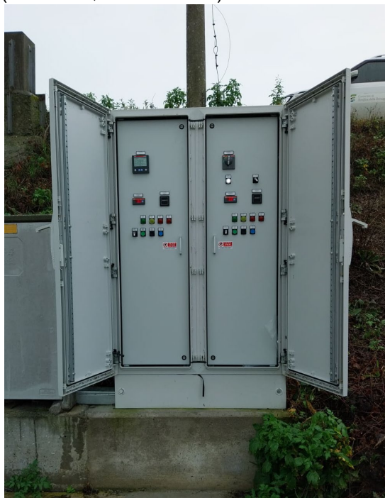
(Foto 4 – Quadro elettrico)
