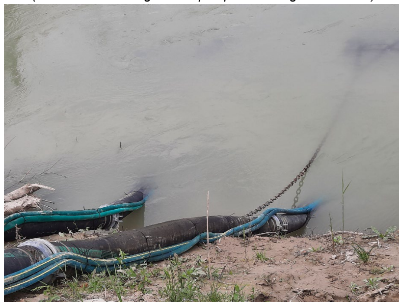
(Foto 2 – Tubazioni di mandata in uscita dalle elettropompe sommergibili)
