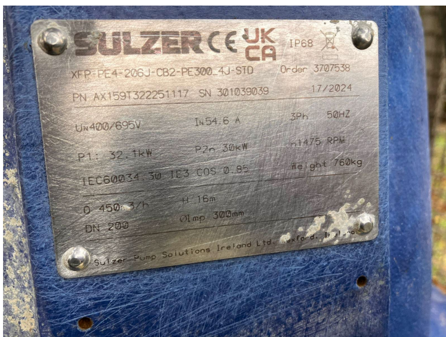
(Foto 1 – Dati di targa elettropompe sommergibili installate)
