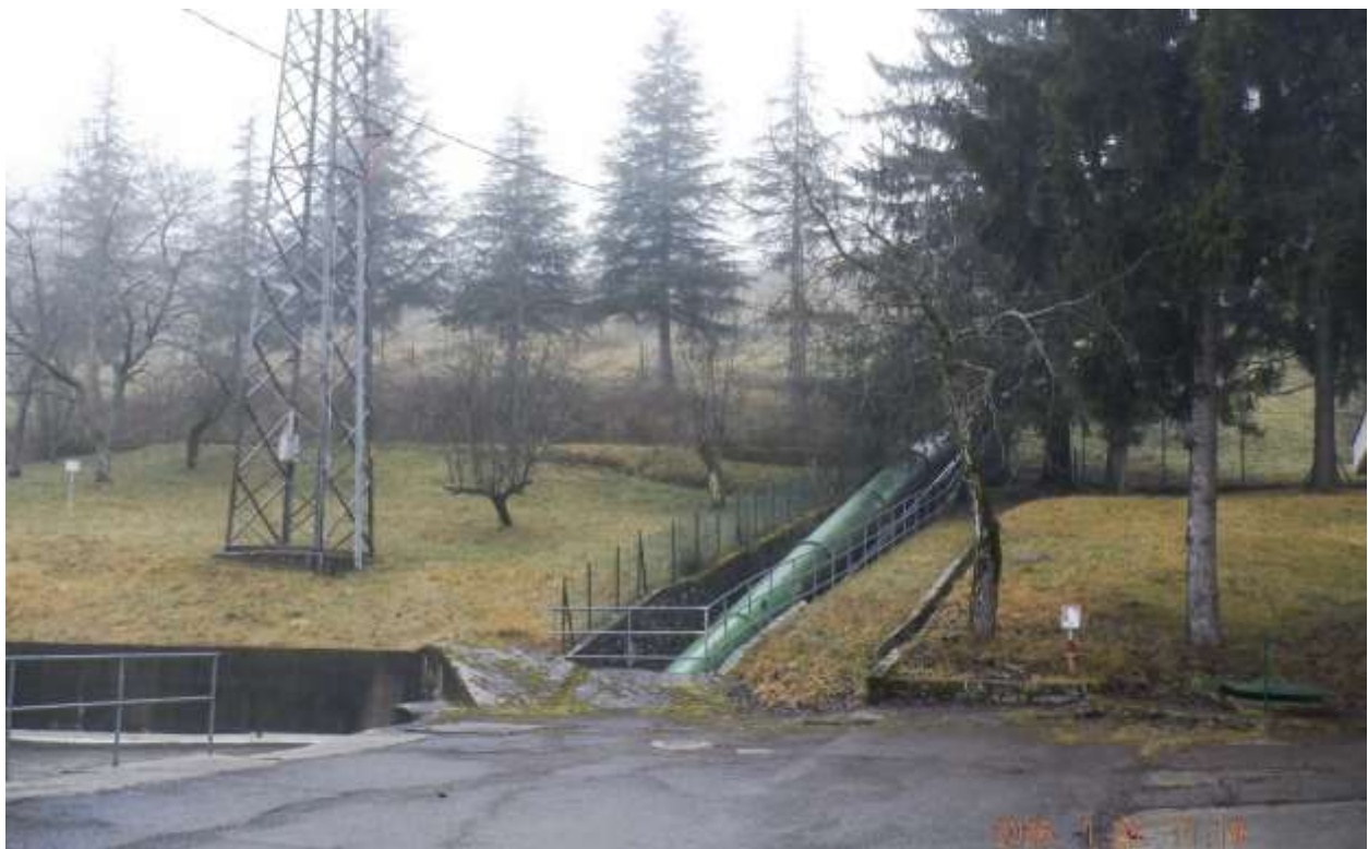
Figura 4-6: condotta forzata in ingresso alla centrale
