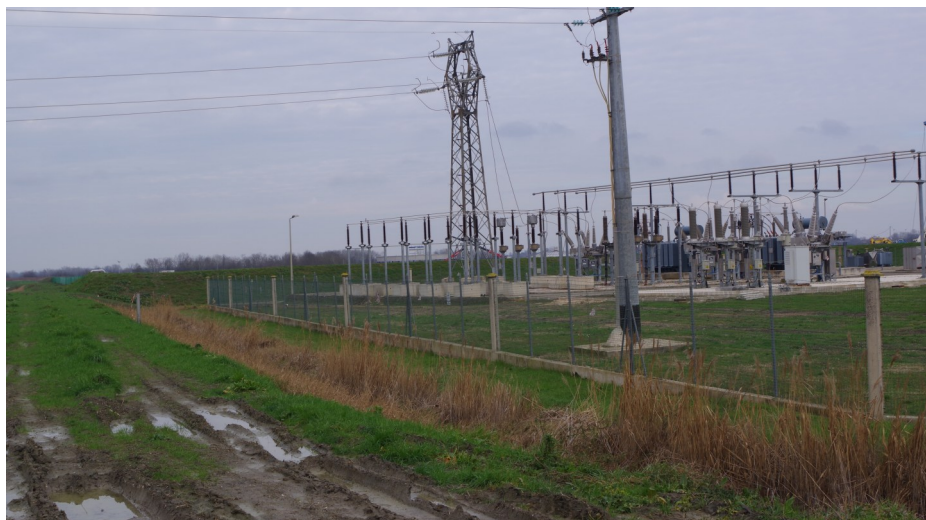
Vista verso l'agrivoltaico in progetto da SP 59, cabina primaria e-distribuzione
