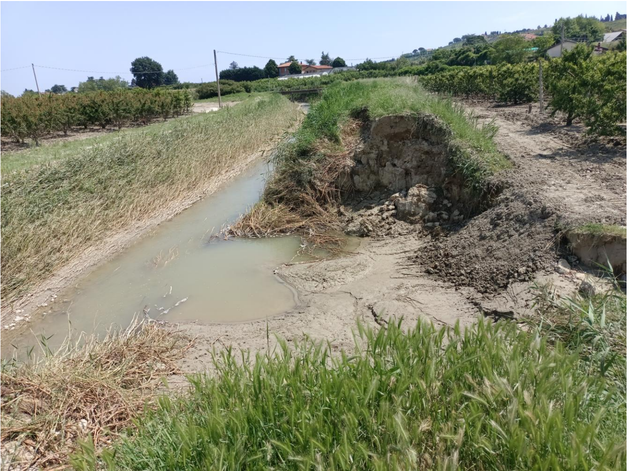
Figura 6 – Comune di Montiano, località Case Francisconi, torrente Pisciatello, monte del ponte di Via Tagliabraccio, vista verso valle
