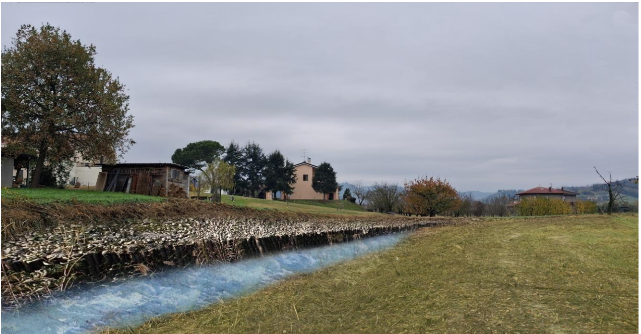
Figura 15 – Fotoinserimento comparativo Intervento B, Comune di Cesena, località Calisese, torrente Pisciatello, monte del ponte di Via Calisese, particolare palificata
