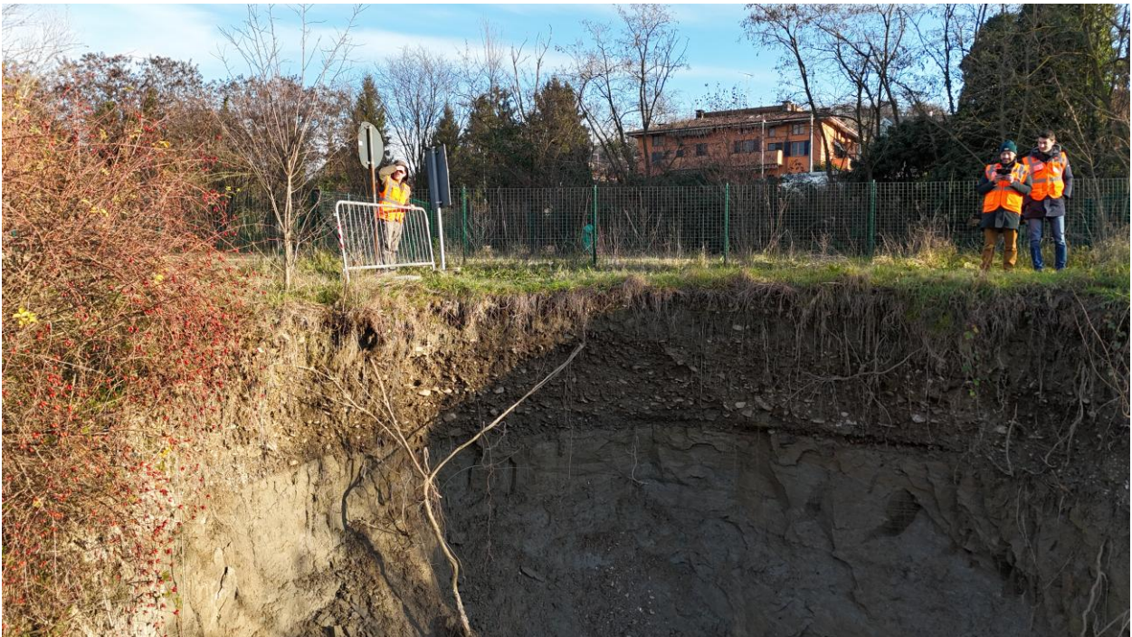
Alcune immagini di franamenti della sponda destra con presenza di scarpate a forte pendenza
