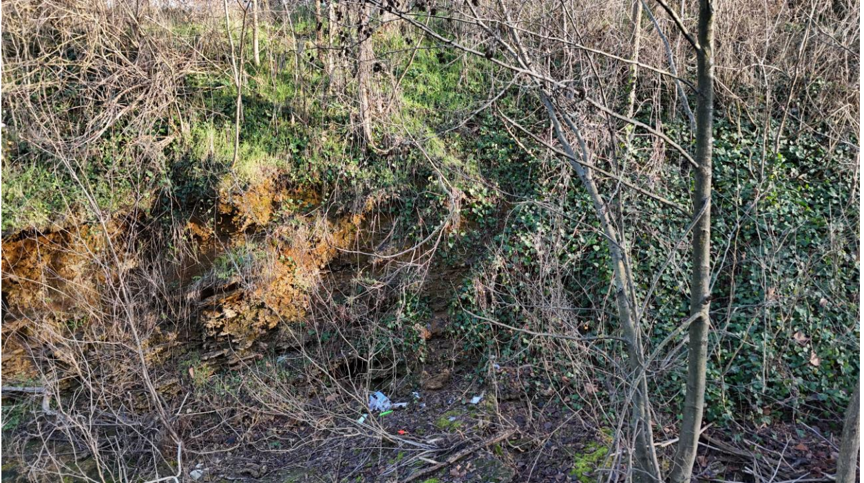
Particolare della sponda di sinistra con evidenza di franamenti anche in porzioni di sponda più basse (corrispondenza indicativa a sezioni S8 e S9)
