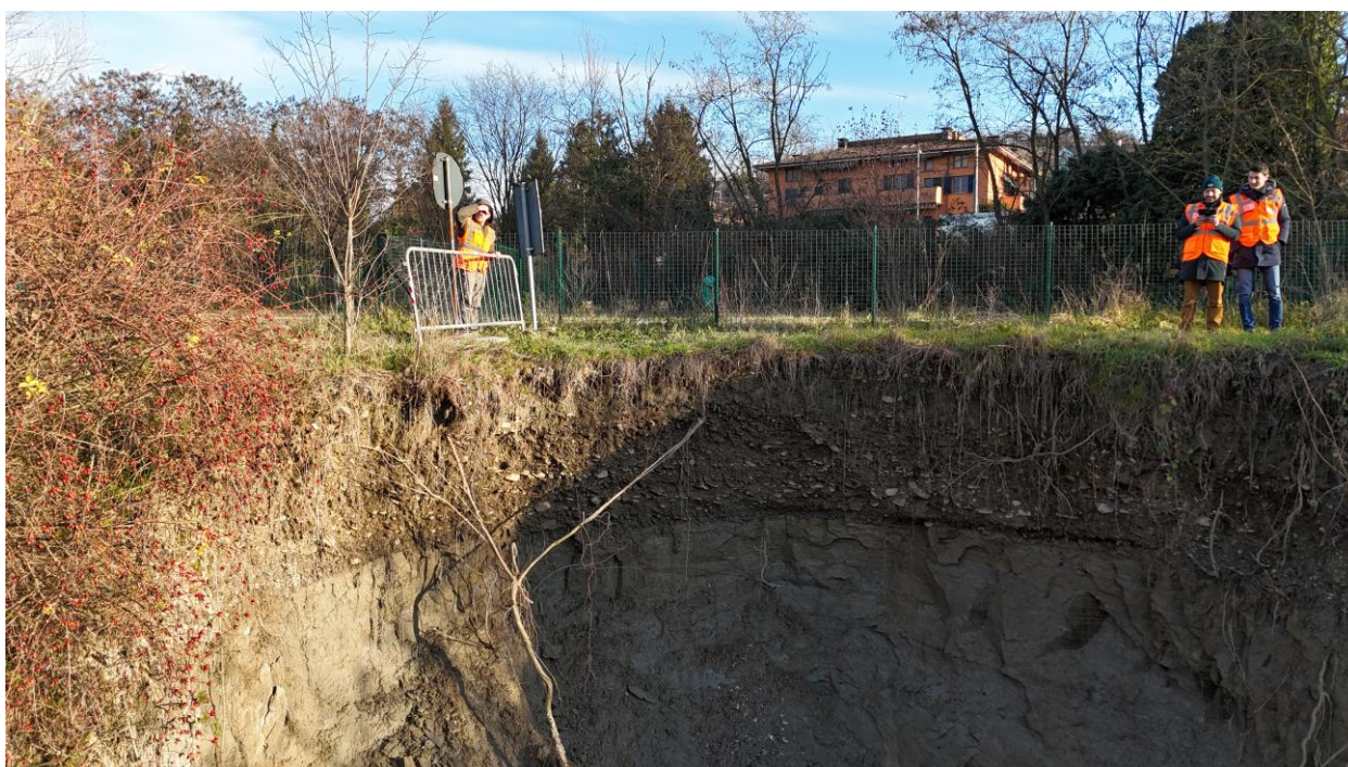
Vista ravvicinata delle porzioni di sponda destra franate (sezioni S11 – S12 e vicinanze)
