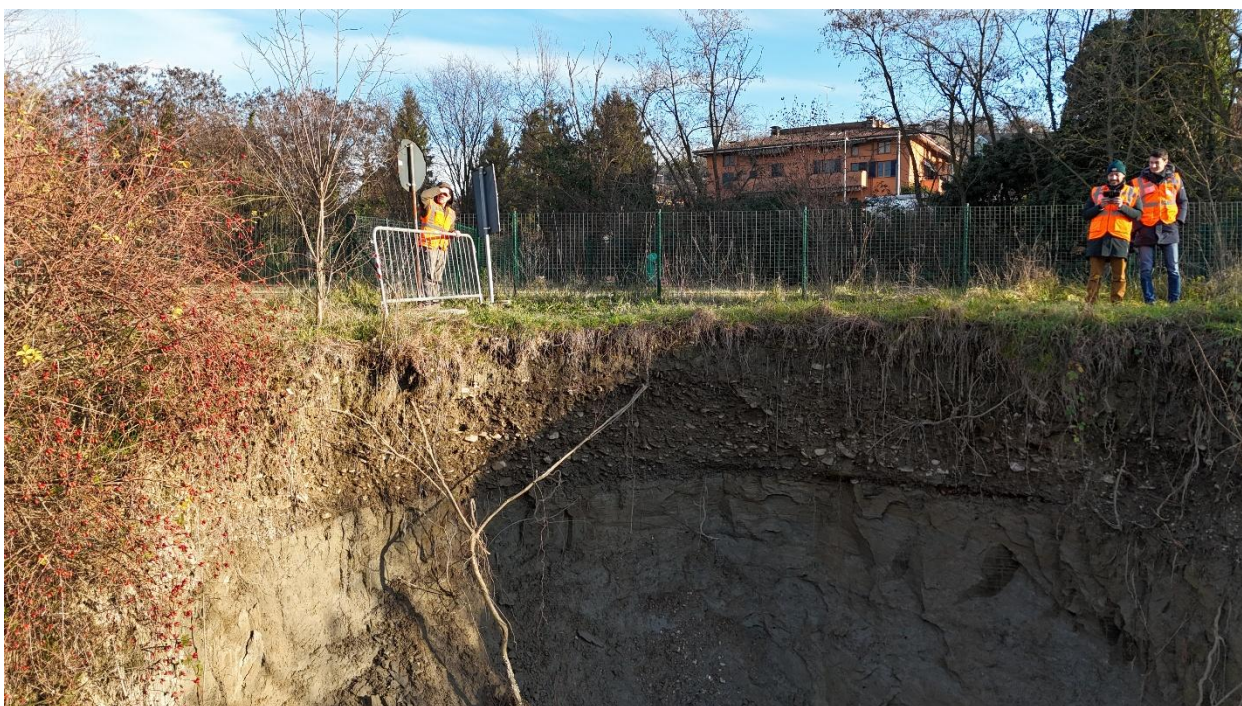
Figura 20 Vista delle porzioni franose in sponda destra con aree inerbite in piano campagna
