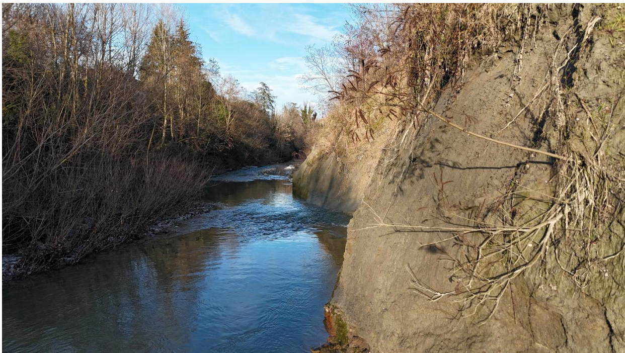
Figura 19 Vista delle porzioni franose in sponda destra con assenza di vegetazione
