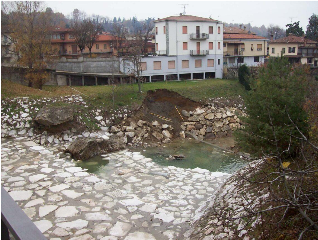
Figura 1 – Lavori sulla soglia del ponte della SP 4 – ripresa dal ponte, da monte verso valle – (2007, Servizio Tecnico di Bacino)
