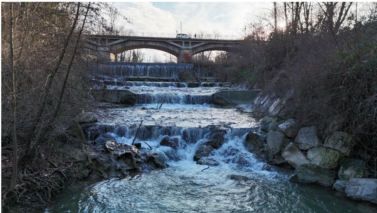
Figura 18 Vista dei risalti e del ponte immediatamente a monte dell'area di intervento
