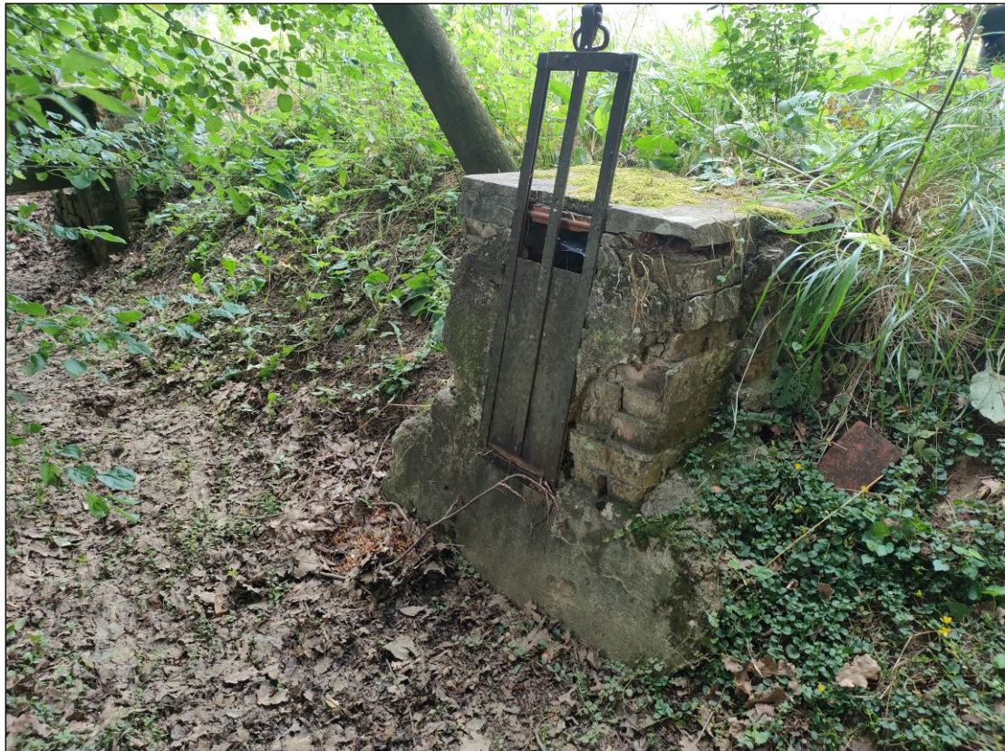
FIGURA 4-26 PARATOIA NEL TRATTO E.A DELLA CANALINA DI VIGNALE
