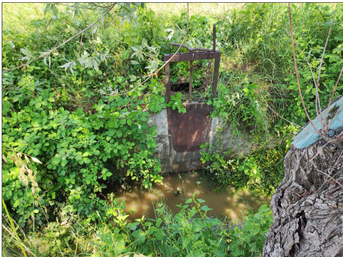
FIGURA 4-27 PARATOIA NEL TRATTO E.A DELLA CANALINA DI VIGNALE
