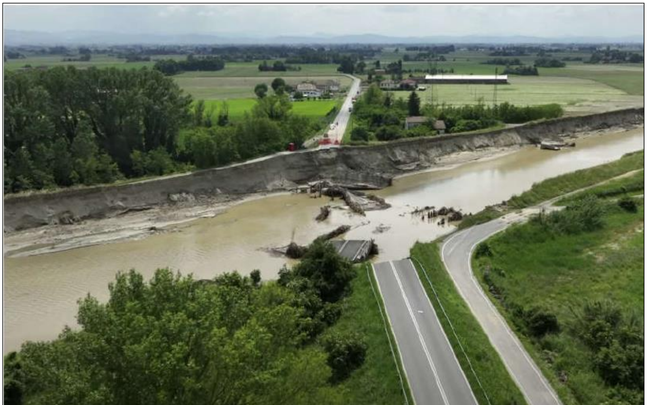
Figura 2 Vista dell'attraversamento a seguito del crollo (16/17 maggio 2023)
