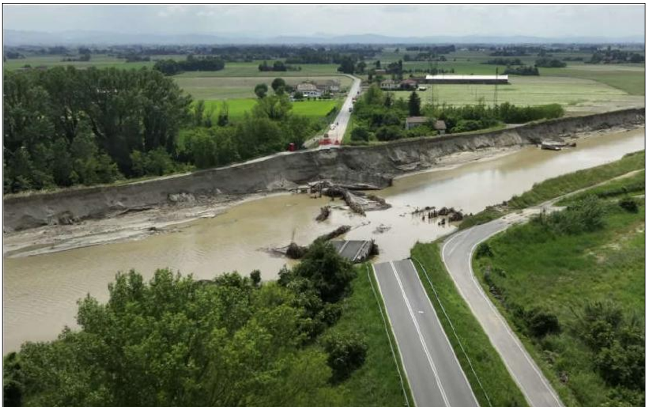
Figura 2 Vista dell'attraversamento a seguito del crollo (16/17 maggio 2023)
