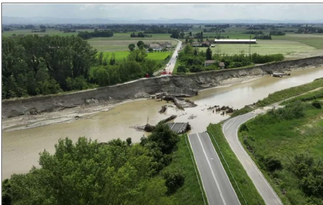
Figura 2 Vista dell'attraversamento a seguito del crollo (16/17 maggio 2023)
