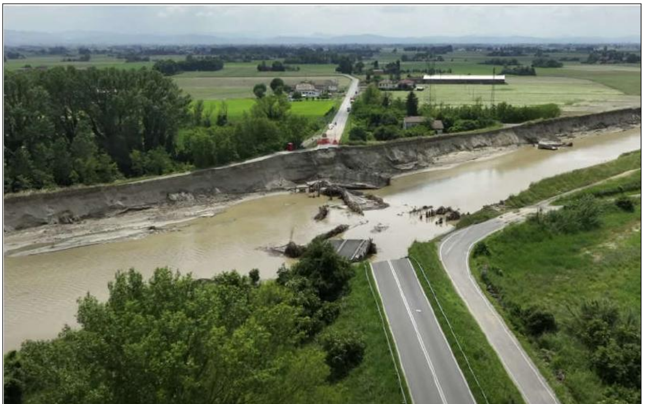
Figura 2 Vista dell'attraversamento a seguito del crollo (16/17 maggio 2023)
