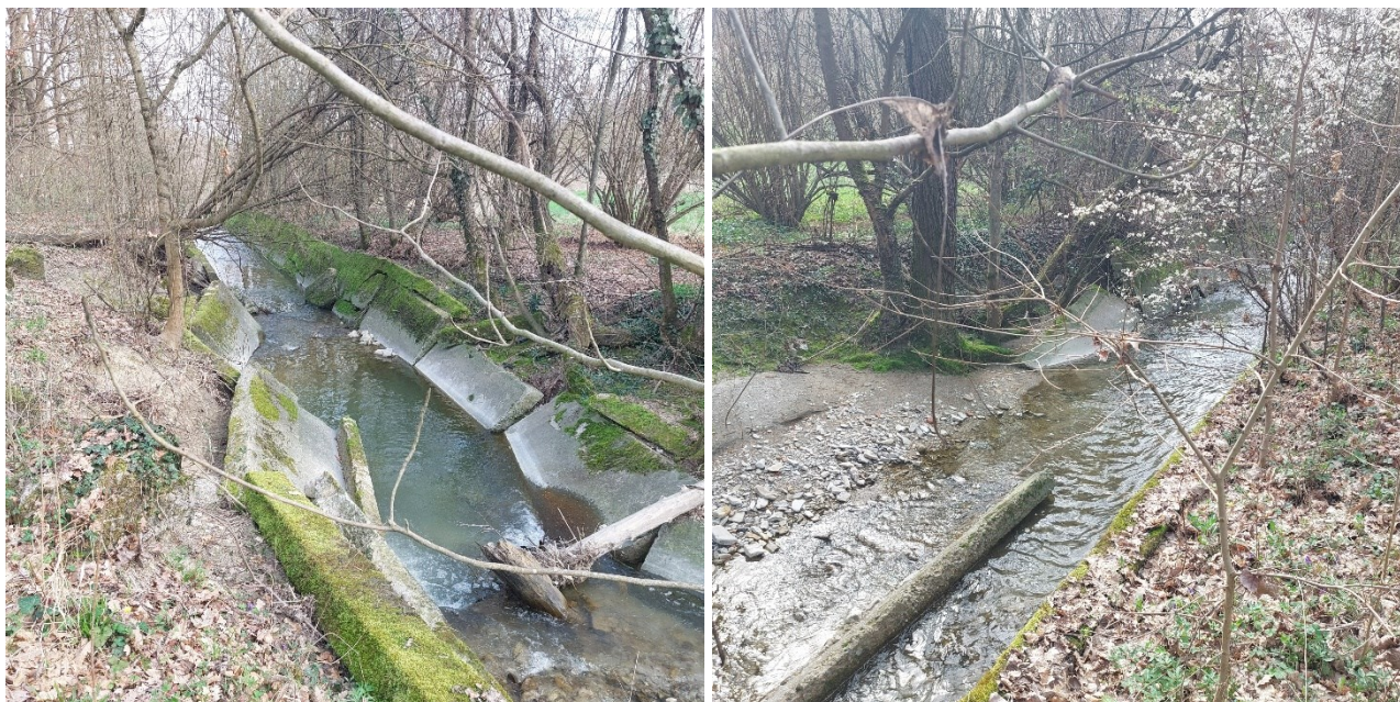
Figura A.4 – Vista dal punto di ripresa n. 3 e n. 4. Tratto artificializzato del torrente in cui le sponde realizzate mediante blocchi di cemento richiedono un intervento di manutenzione. Si prevede la rimozione dei blocchi in cemento e la sostituzione mediante riprofilatura delle sponde e scogliera in massi ciclopici sulla sponda destra a protezione dell'argine dell'invaso di laminazione.
