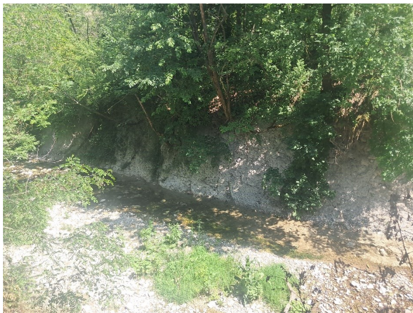
Figura A.7 – Vista dal punto di ripresa n. 8. Erosione della sponda destra del torrente Ghiara a valle della cascata. Zona in cui verrà realizzata una scogliera in massi ciclopici.
