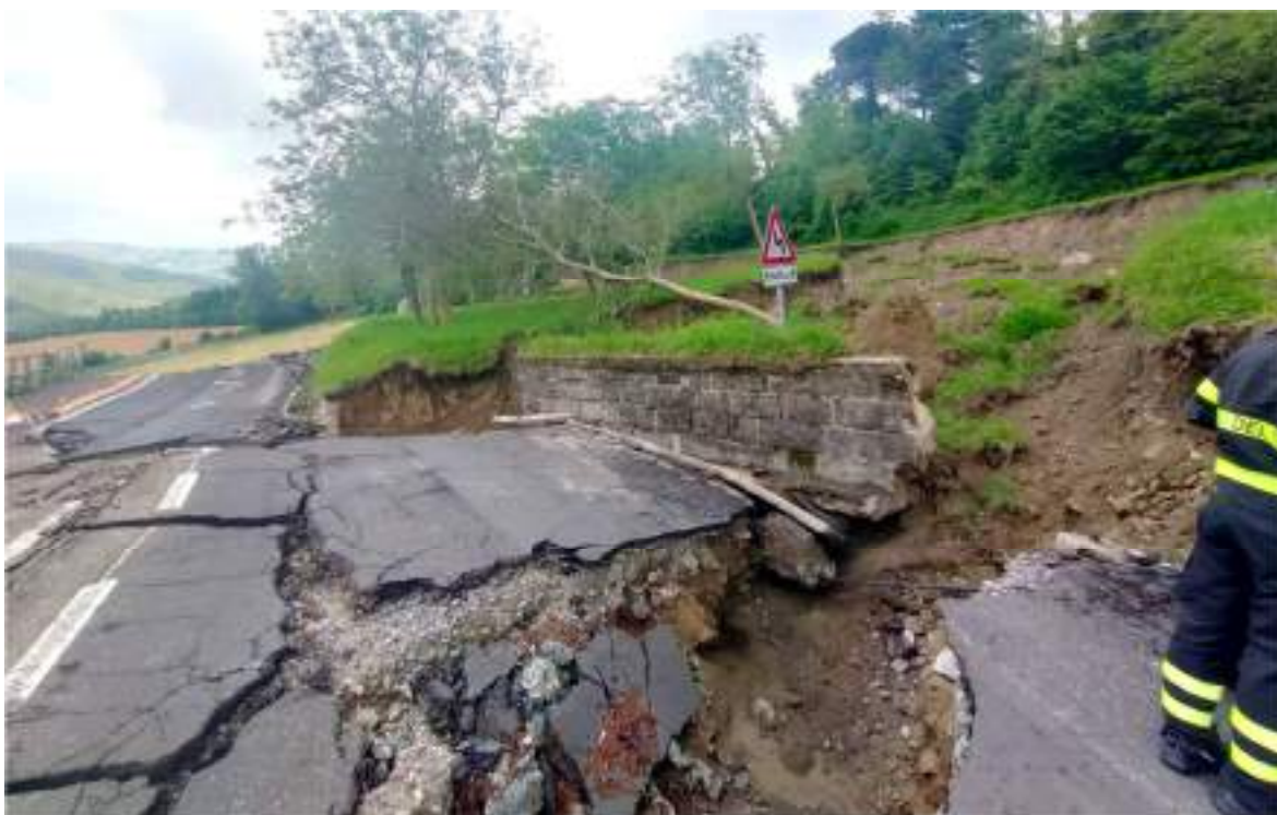
Foto 5: Vista della frana con la strada ed il muro di contenimento traslati a valle
