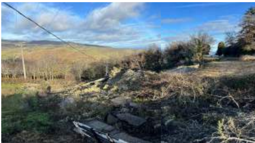
Foto 1: Vista della frana da valle della strada
