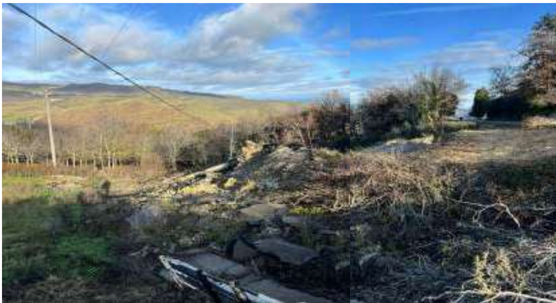
Foto 1: Vista della frana da valle della strada
