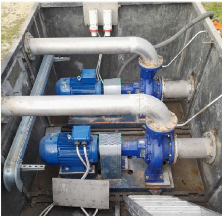
Figura 3- Le due pompe dell'impianto Bastia
