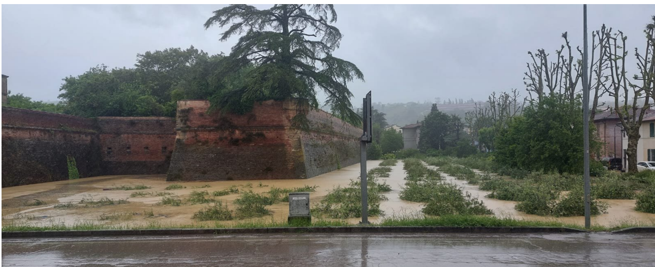
Figura 4 - Immagine risalente agli eventi estremi dell'alluvione di maggio 2023, in cui è visibile il fossato che circonda il Bastione di Santa Maria completamente allagato: l'acqua penetrò all'interno del livello di gallerie inferiori causando l'abbandono delle colonie di chiroteri, che non sono più tornate a frequentare questi luoghi.
