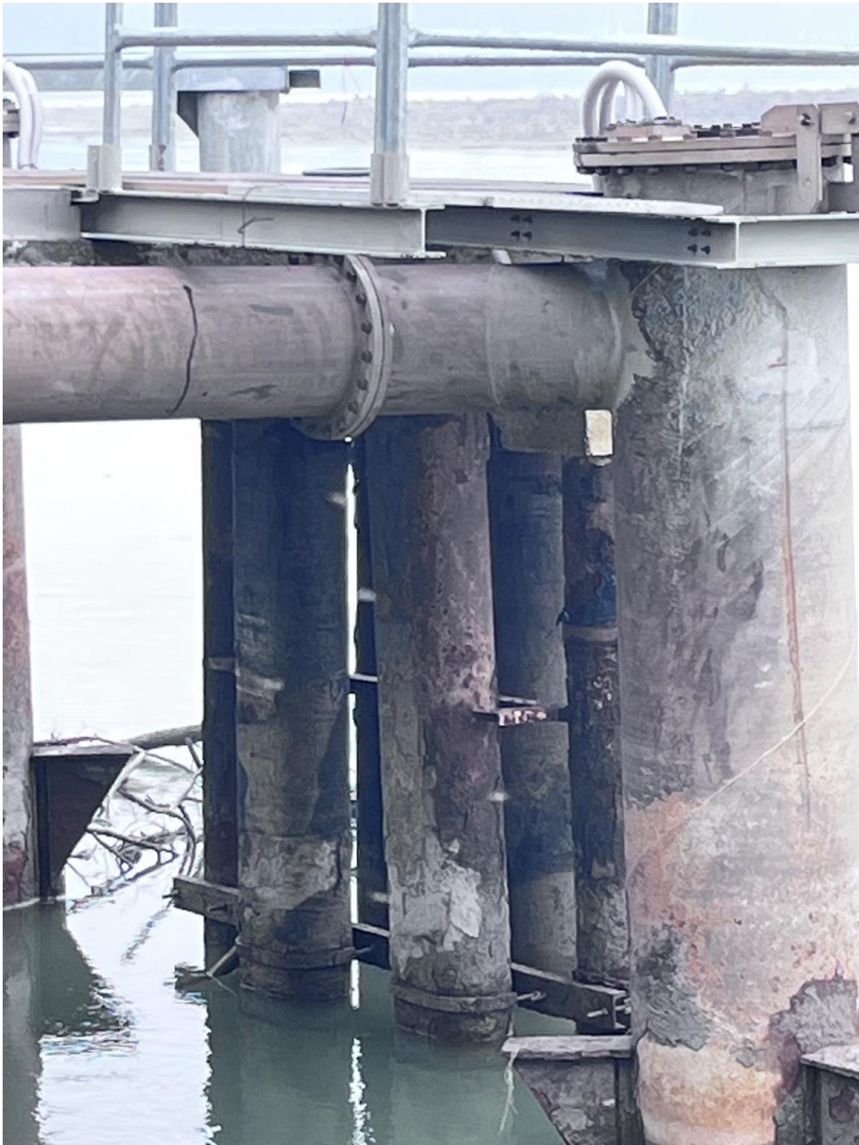
Foto 3 – Vista da argine delle elettropompe
