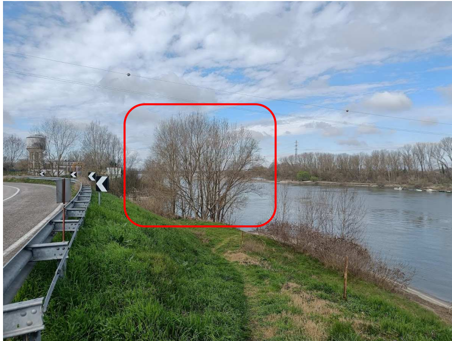
Foto 3: vista est-ovest della sponda in comune di Ferrara ove vegetano gli otto giovani esemplari arborei oggetto di taglio per manutenzione ordinaria della linea elettrica (sopra le chiome si notano i cavi aerei)
