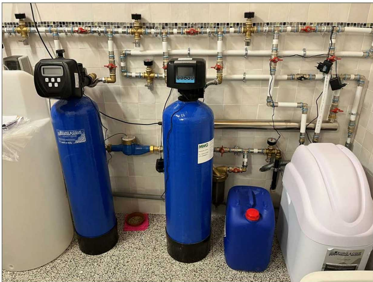
Immagine 3.1-1 Impianto di trattamento
