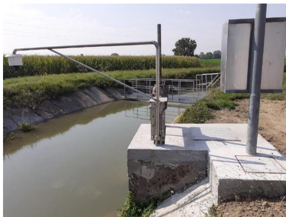
Teleidrometro per la misurazione del livello idrico
