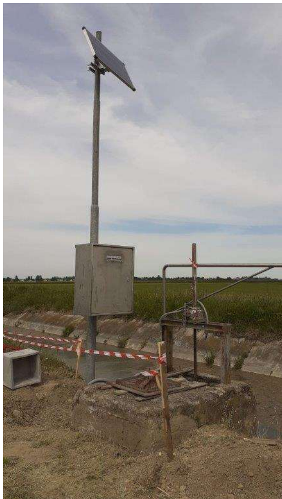
Quadro di alimentazione e di alloggio per la centralina elettronica
