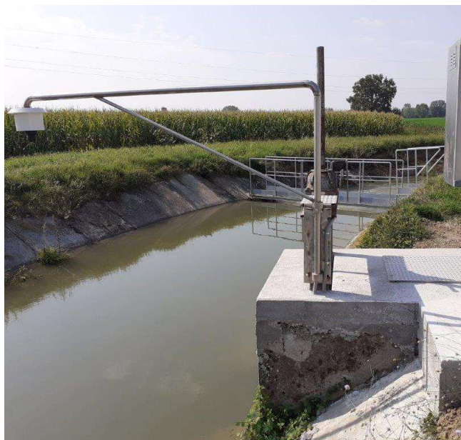
Teleidrometro per la misurazione del livello idrico
